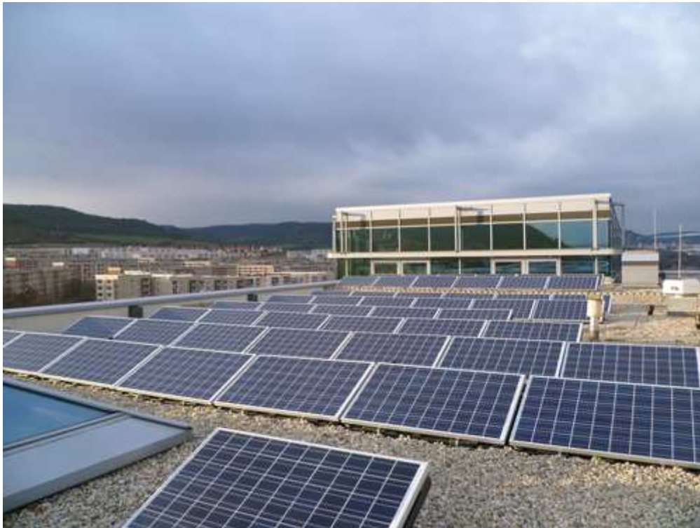
Foto: Stadtwerke Jena
